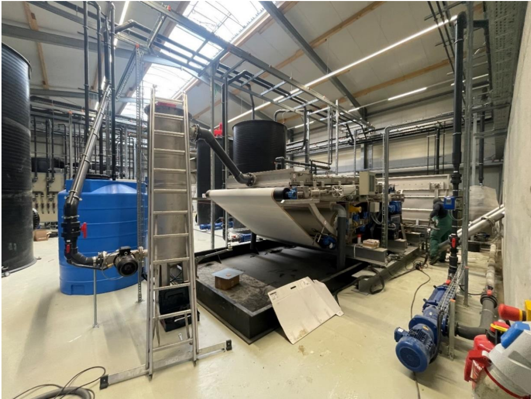
Technikinstallation KUMAC-Anlage (Umkehrosmose)
