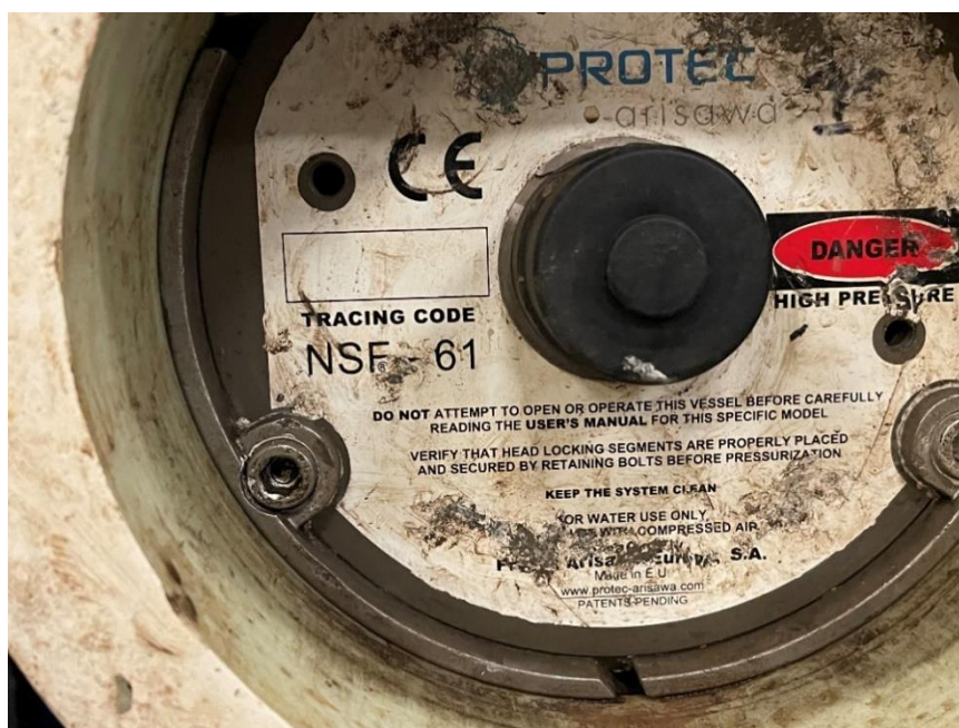
Kopf einer Membranröhre – jährlicher Tausch der Membranen
