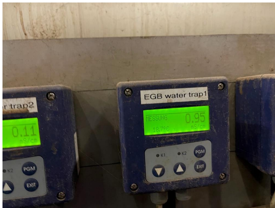
Anzeige Leitfähigkeit Klarwasser
