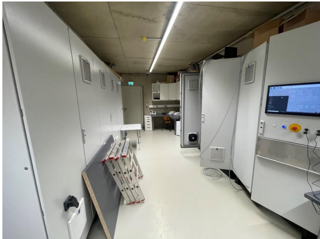
Technikinstallation KUMAC-Anlage (Elektroanlage – Schaltschrankraum)
