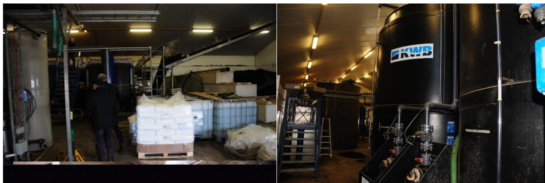
Lagerung Flockungsmittel u. Chemikaliertanks für Eisensulfat u. Schwefelsäure
