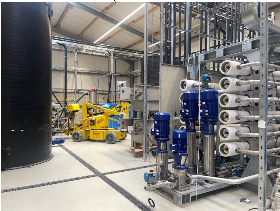
Technikinstallation KUMAC-Anlage (Siebbandpresse)
