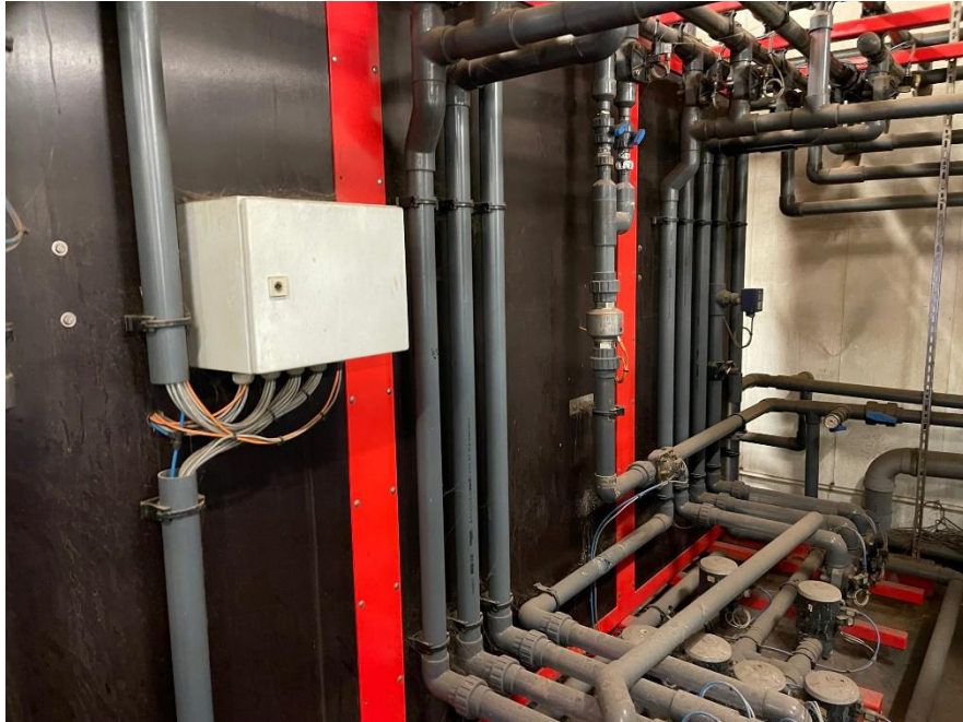
Rohrleitungen mit Sensorik
