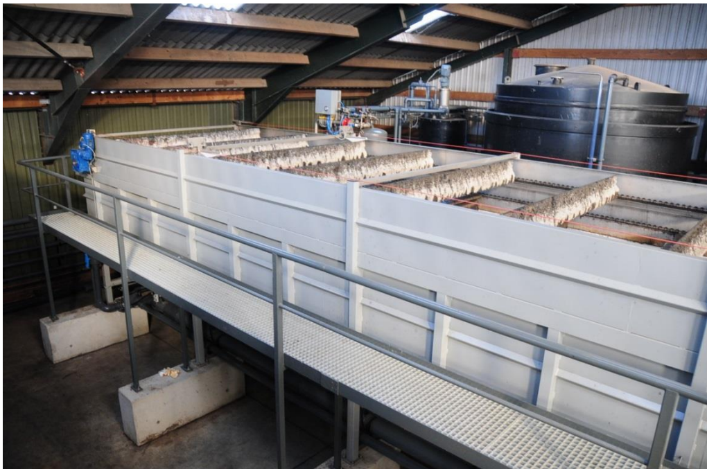
Flotationsbecken mit Abstreifer
