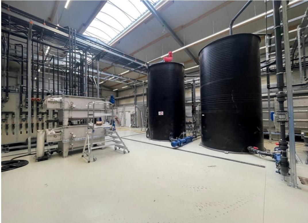
Technikinstallation KUMAC-Anlage (Leitfähigkeitsmessbereich u. Chemikalienlager)
